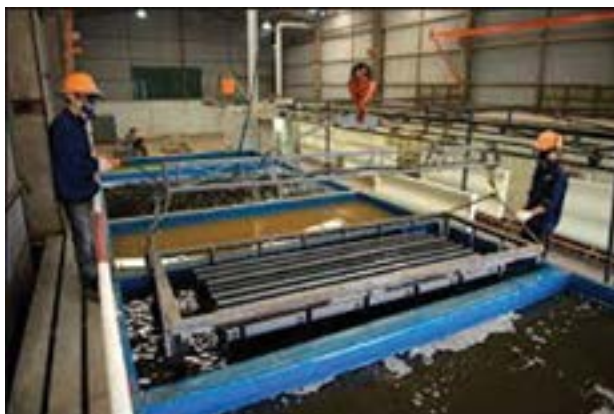
Hệ thống bể phốt phát / Phosphat tank system
